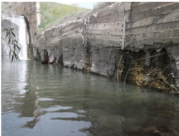
Рисунок 1 – Разрушенный бетон левобережной
