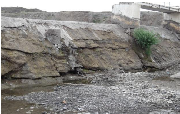
Рисунок 2 – Разрушенный водослив подпорной стенки водовыпуска
