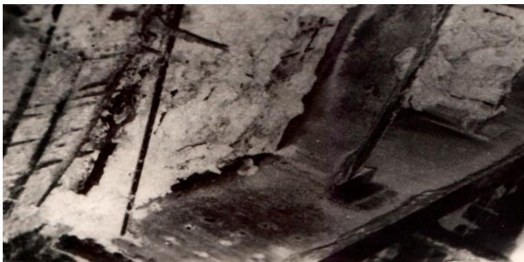
Рисунок 1 – Скопление пыли на перекрытии
