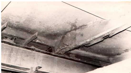
Рисунок 2 – Трещины между полкой и продольным ребром. Повреждения продольных ребер плит в опорной части
