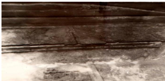
Рисунок 3 – Повреждение продольных ребер в середине пролета и коррозия рабочей арматуры плит
