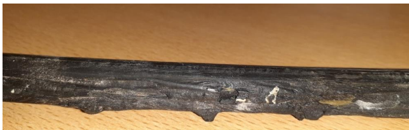
Рисунок 1 – Поврежденный оптический кабель
